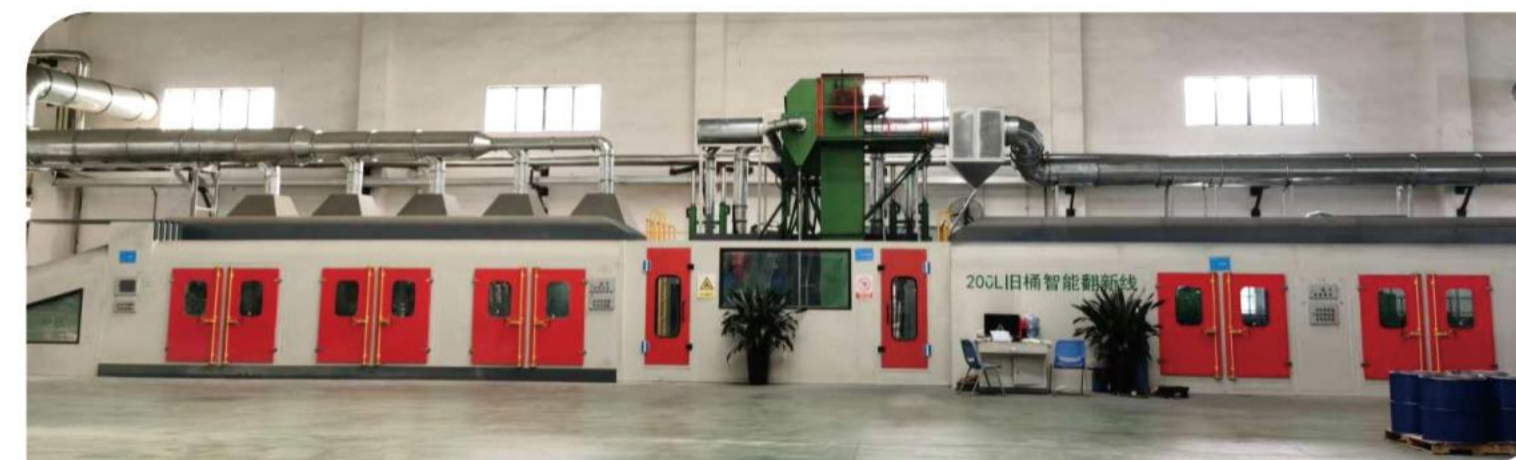
200L危废铁桶全自动翻新线
