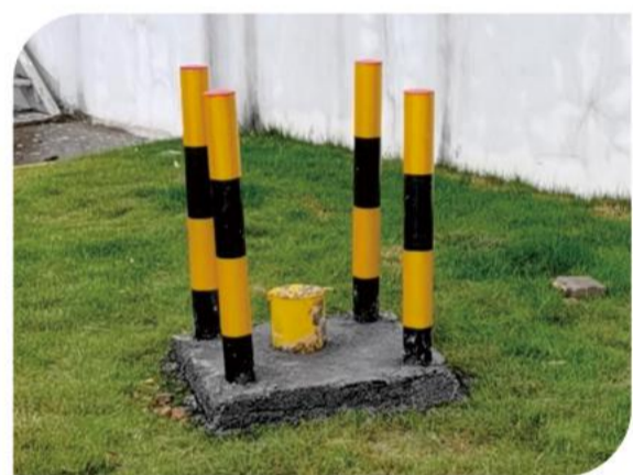
地下水监测井
